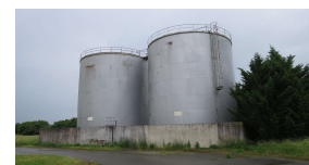
Parcelle d'une grande surface sur laquelle se trouve deux anciennes cuves à huiles détériorées.
