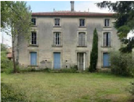
La maison Roulet, état existant : bien qu'ayant gardé son caractère d'origine, le bâti d'une surface de 210 m2 est dans un état très dégradé et nécessite des travaux de réhabilitation de la toiture.
